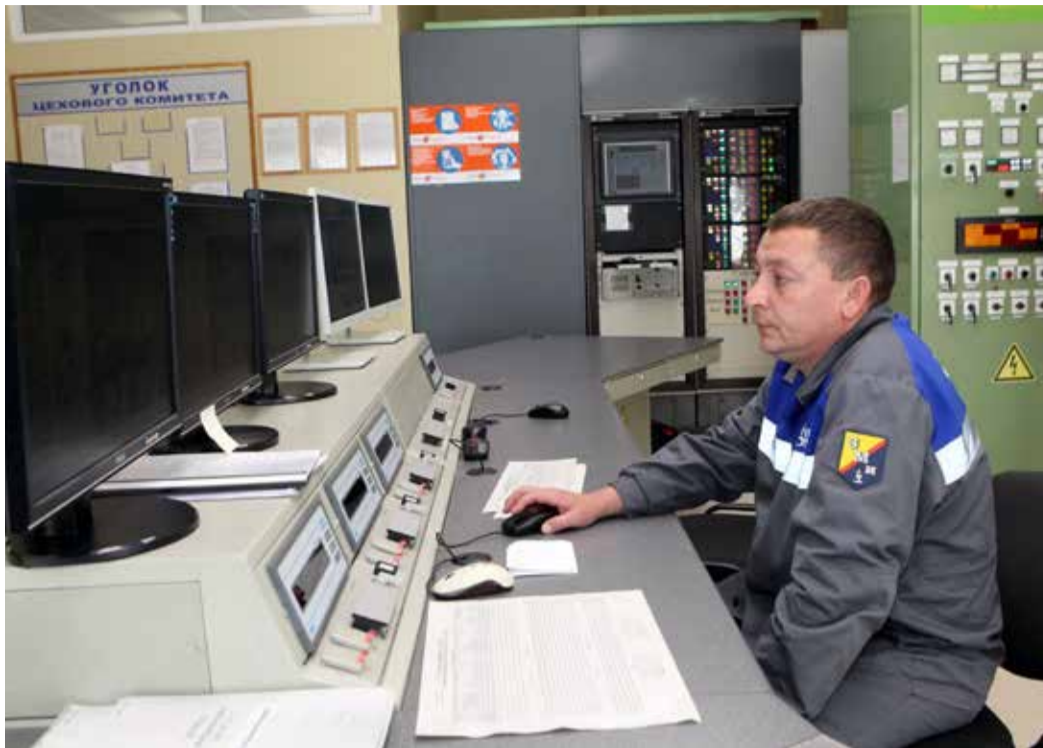
Мозг любой газоперекачивающей станции – диспетчерская. Сюда стекаются данные со всех объектов
