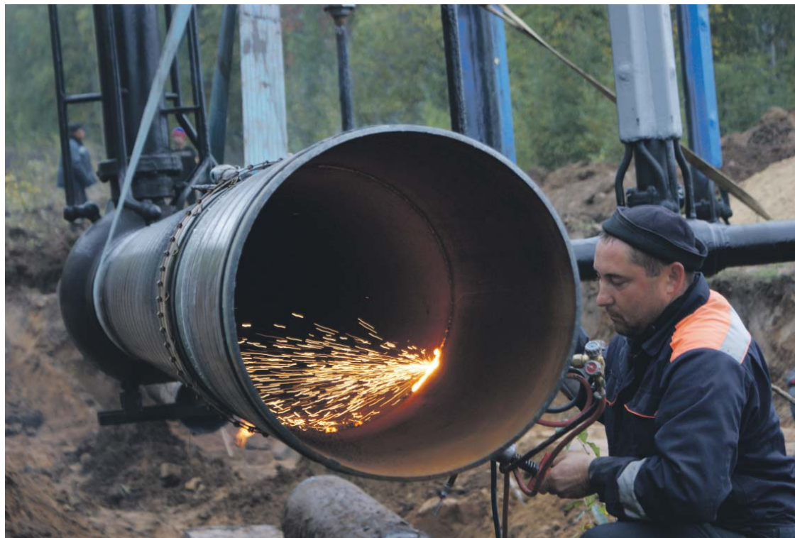
Безаварийная работа магистральных трубопроводов в основном зависит от своевременно и качественно проведенного капитального ремонта
