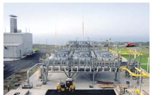
Компрессорная станция «Береговая», от которой берет начало газопровод
